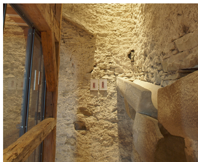
Letzte Spuren des Pulldachs : Vom Pulldach floss das Wasser in die grosse Rinne und wurde anschliessend über die Öffnung in der Ostwand nach aussen abgeleitet.
